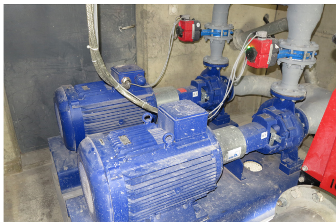
Nouvelles pompes de 45 kW à entraînement direct
